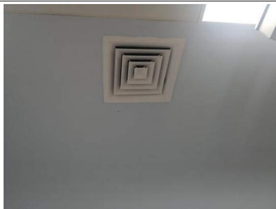
机房通风设施
