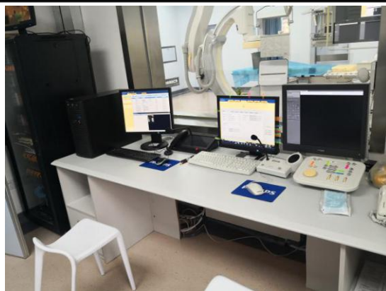
机房监控及对讲系统
