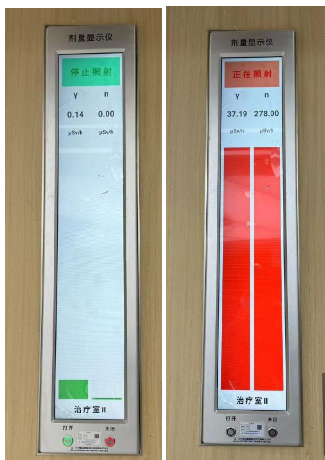
图 4.1.2-9 防护门外剂量柱现场照片（示意）
